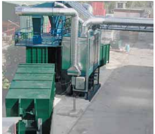
Nagyteljesítményű gépeket kiszolgáló rendszer külön blokkban
